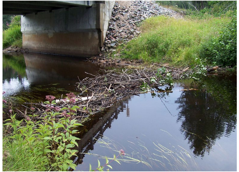
Photo 6. Barrage de castor au pied d'un pont, La Tuque, Mauricie.
